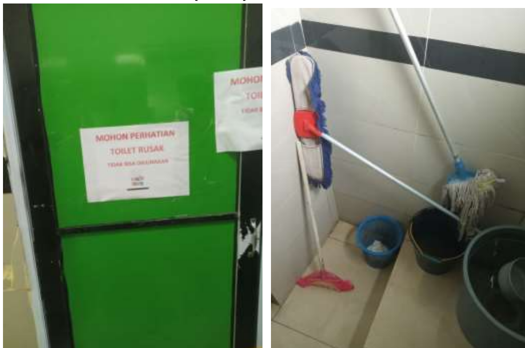
Gambar I.1 Kondisi Toilet pada Instalasi Rawat Jalan Rumah Sakit Umum (RSUD) Kota Dumai
